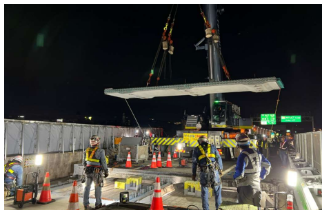
中国道リニューアル工事 宝塚IC～神戸JCT間 有馬川橋での施工状況
