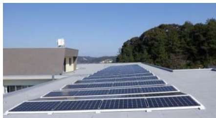
太陽光発電設備整備事業
